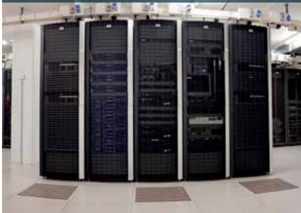
Le data center Safe Host à Genève
