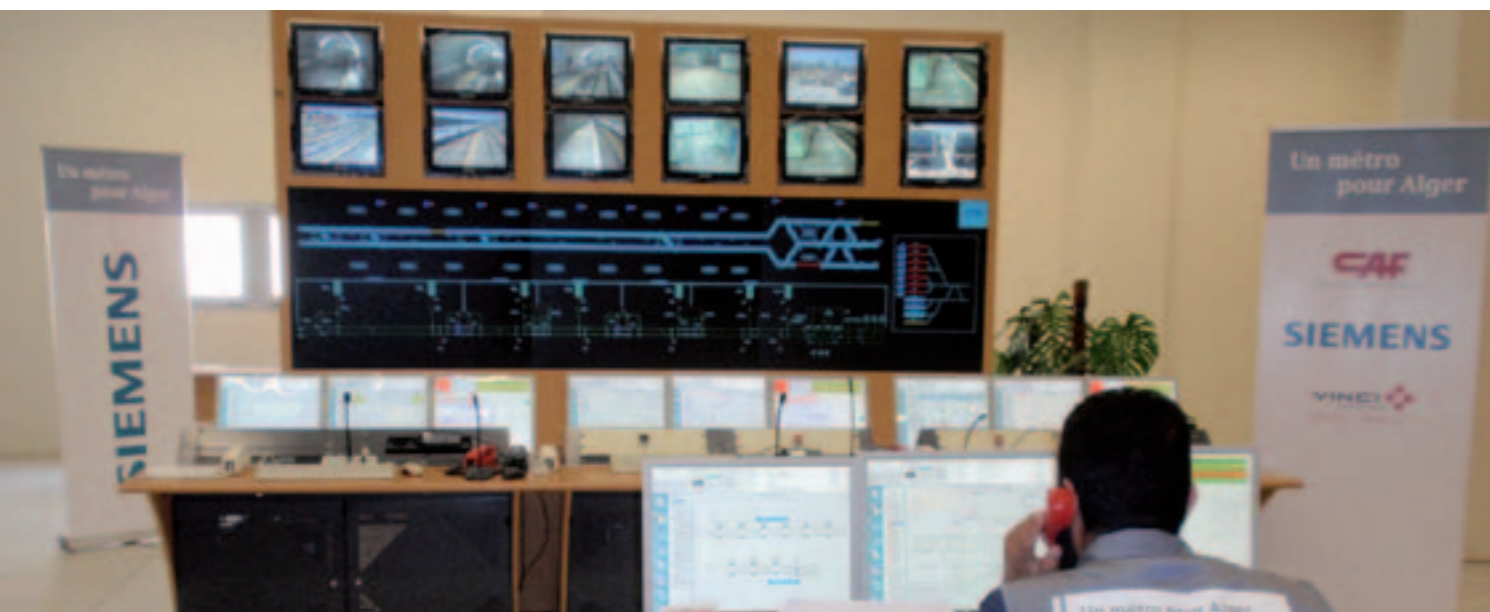
Le Poste de Commande Centralisée de la ligne 1
