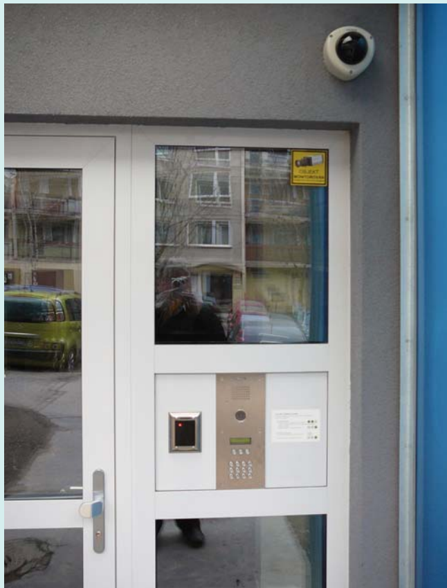
Vstup do domu střeží elektronický čipový systém a kamera
